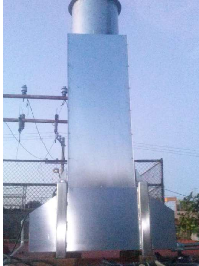
Torre de Enfriamiento
